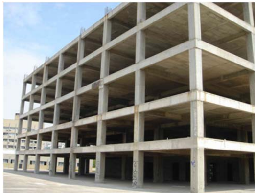
Σχ. 4.6.1-3 Επίπεδο αμιγές πλαίσιο ως υποφορέας μιας χωρικής μικτής κατασκευής πλαισίων-τοιχωμάτων που φέρουν πλάκες στις στάθμες των ορόφων.
